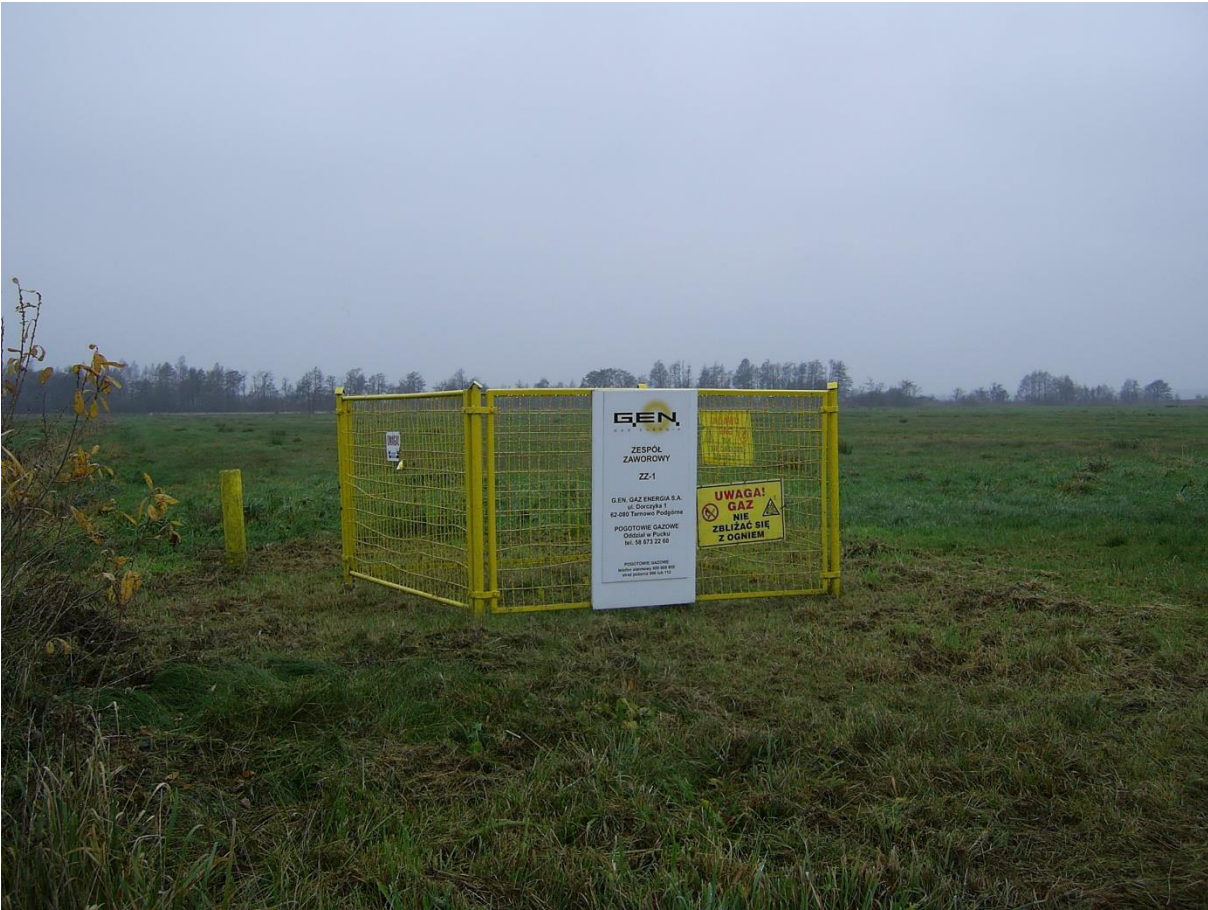
Fot. 1. Infrastruktura techniczna związana z przesyłem gazu ziemnego gazociągami podziemnymi
