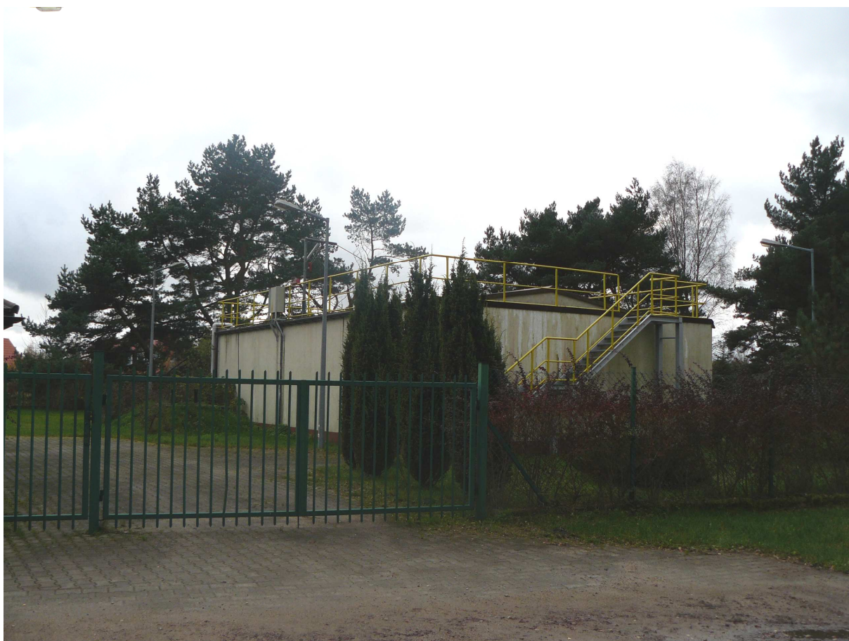
Zdjęcie 6. Obszar objęty projektem planu – przepompownia ścieków
