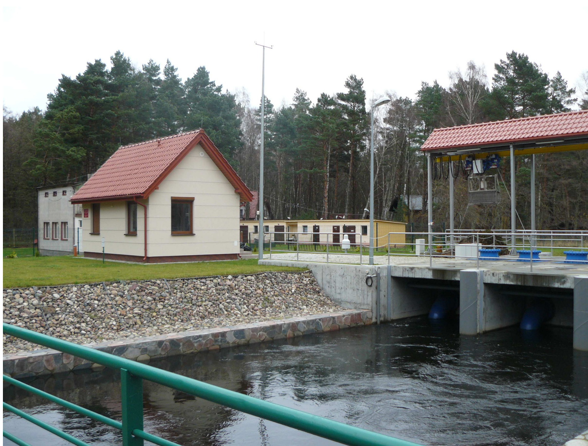
Zdjęcie 1. Obszar objęty projektem planu – stacja pomp
